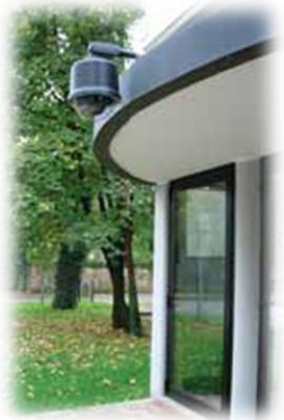
Una videocamera di sorveglianza installata presso la sede municipale
